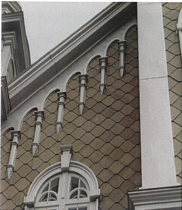
Détails de l'ornementation de tôle. Enjolivures le long de la toiture des pignons et arcs ciselés au-dessus de chaque fenêtre.
