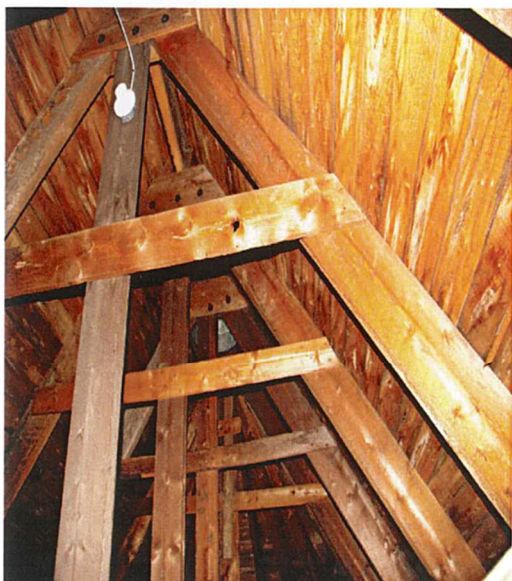
Détails de l'entre-toit. Ferrures et mise en place de système d'alarme.
